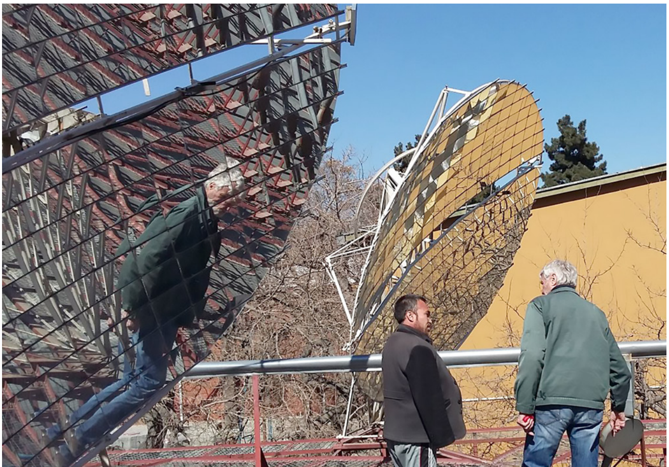
Die von der Werkstatt wiederbelebte Solaranlage mit 12 Parabolspiegeln erzeugt Dampf zur Herstellung von destilliertem Wasser für Krankenhäuser
